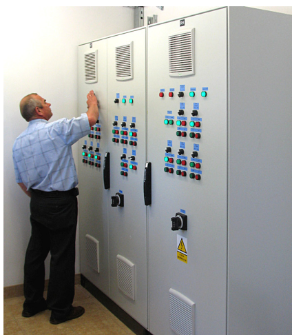
Automatyczne szafy sterownicze na stacji wodociągowej
